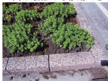
施工後9年が経過した袋
