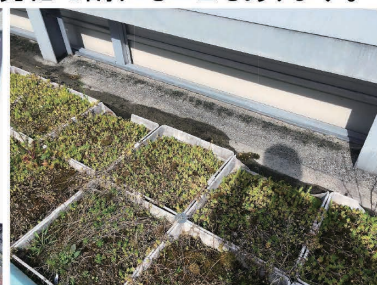
質の悪いパレットが紫外線劣化で割れた例
